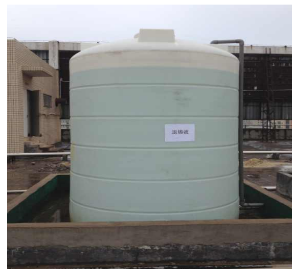
天台退锡液储罐
