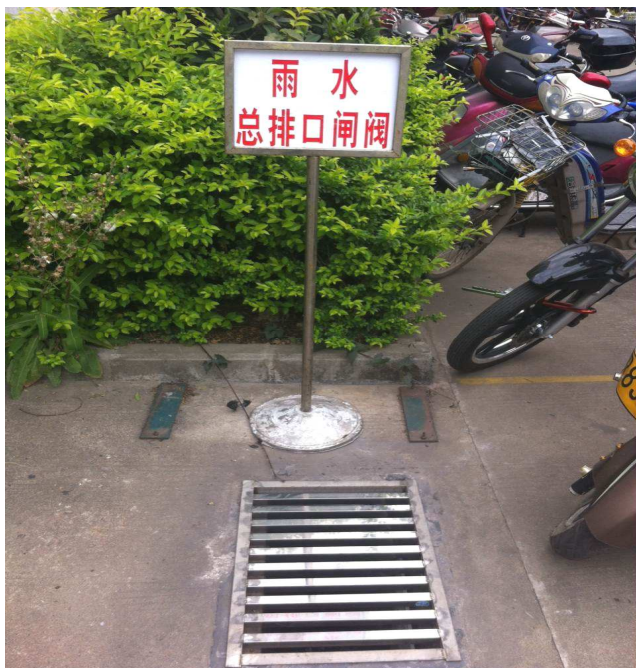
A 雨水总排口闸阀
