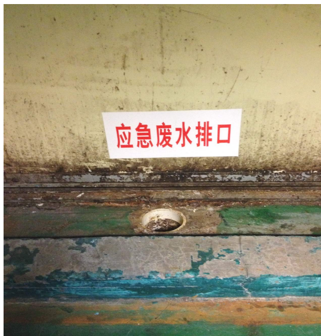
C 应急废水排口
