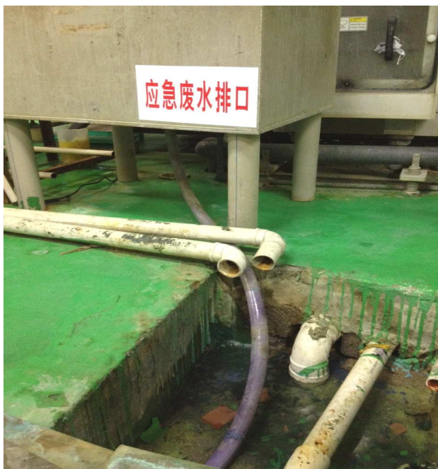
B 应急废水排口
