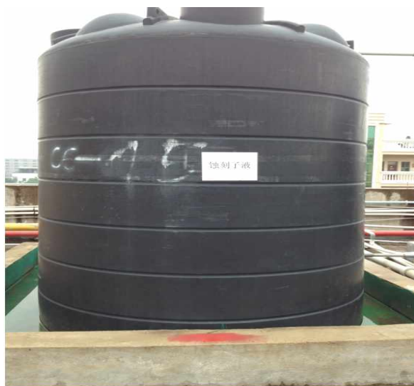
天台蚀刻液储罐
