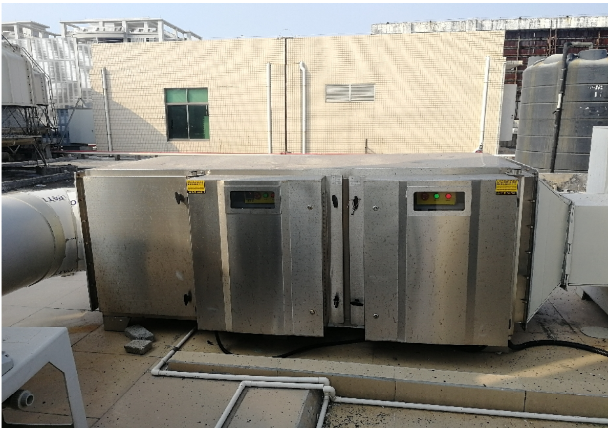
图 5-9 改造后废气处理设施-UV 部分图
