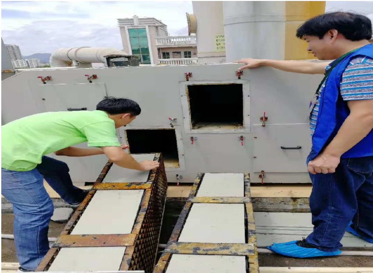
图 5-10 活性炭整改照片
